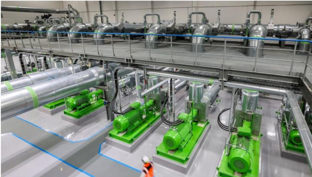
Blick in die Pumpenhalle für Fernwärme eines Heizkraftwerks. Fernwärme könnte ein Baustein für die Energiewende sein. Foto: dpa
